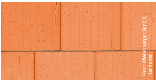
Bild 10: Ziegelmauerwerk mit Trocknungs- oder Brennrissen
