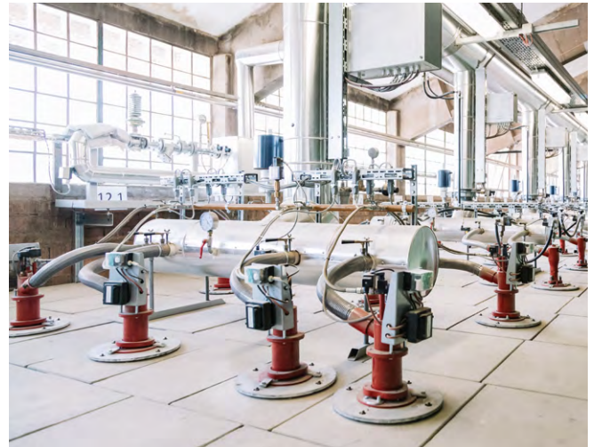
Abbildung 32: Brenner auf einem Tunnelofen; Quelle: LEIPFINGER-BADER GmbH
