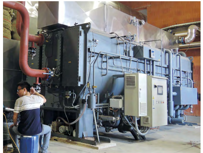
Abbildung 10: Absorptionswärmepumpe; Quelle: Wienerberger GmbH
